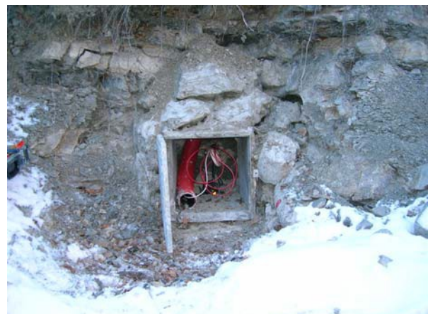
Sotto: alloggiamento dell'estensimetro multibase a 3 teste.
