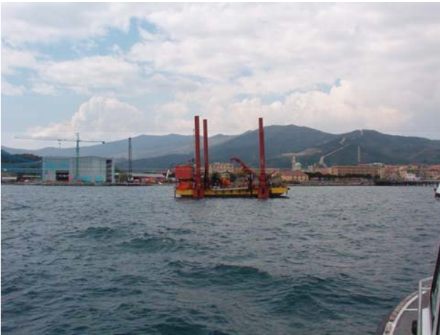
Plattaforma autosollevente sulla quale si sono svolte le indagini al largo del porto di Vado Ligure.
