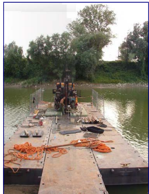
Penetrometro Pc90 e materiale per esecuzione sondaggio a rotazione e prova penetrometrica CPT in alveo fluviale.
