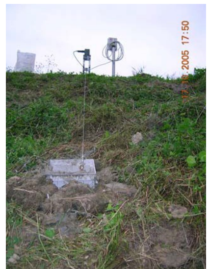
Estensimetro a filo installato sul corpo diga per il monitoraggio del suo movimento nel tempo
