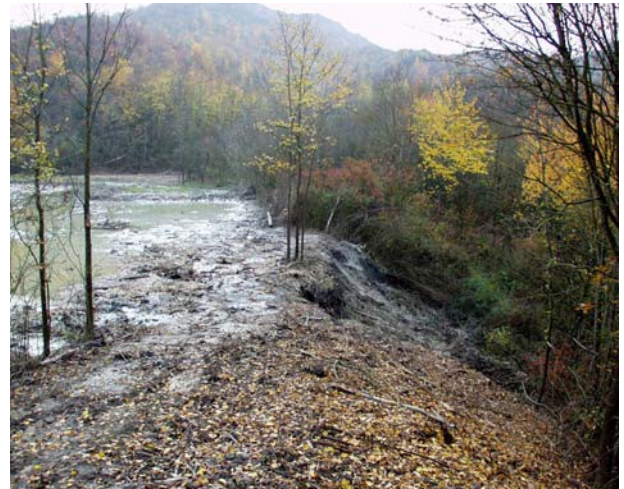
Situazione d'emergenza dello sbarramento in terra del lago nel novembre 2004.
