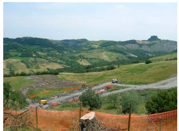
Panoramica degli interventi di ripristino eseguiti al piede della rupe: pozzi drenanti e paratia di pali profondi.
